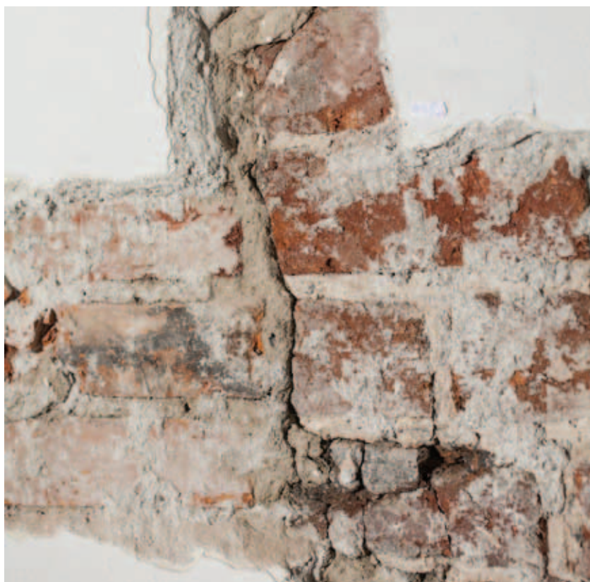
odkrywka KAP-IV-L_2W- ściana północna 1 biała 2 szarobłękitna 3 kremowa 4 tynk szary, wapienny z dodatkiem cementu 5 tynk kremowoszary 6 zabrudzenie 7 cegła
