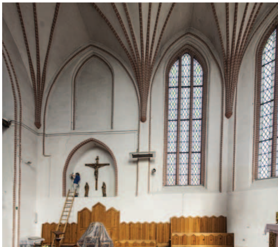
PREZBITERIUM ŚCIANA PÓŁNOCNA zdjęcie stanu zachowania oraz rysunek ze zmapowaną typologią zniszczeń
