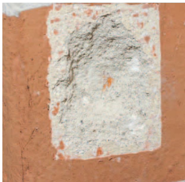
odkrywka N-I-L_7S- żebro 1 czerwona 2 błękitna 3 kremowa 4 tynk szary, wapienny z dodatkiem cementu 5 cegła
