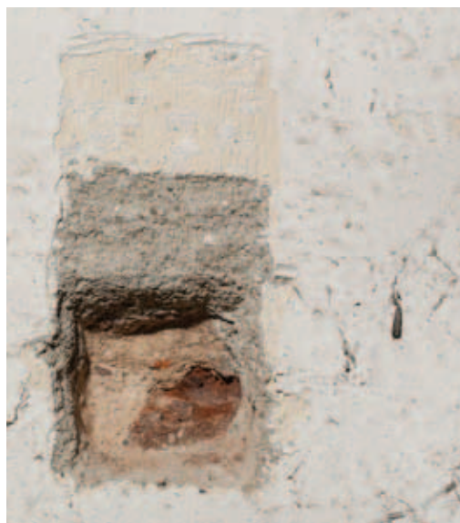
odkrywka CH-II-L_1W- ściana północna 1 biała 2 błękitna 3 kremowa 4 tynk szary, wapienny z dodat- kiem cementu 5 tynk jasnoróżowy 6 cegła
