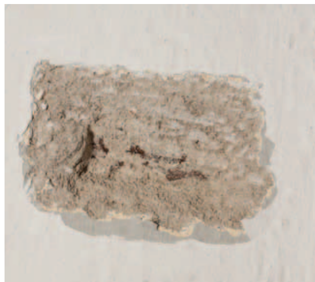
odkrywka SK-VI-L_2W- ściana południowa, glif 1 biała 2 szara 3 kremowa 4 tynk szary, wapienny z dodatkiem cementu 5 cegła
