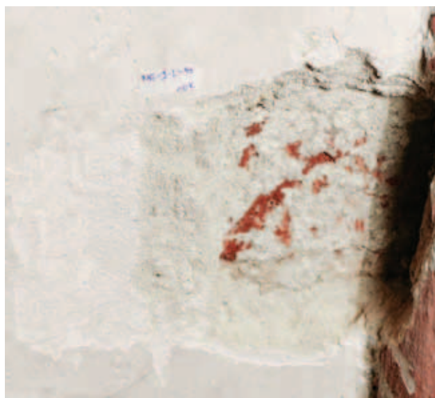
odkrywka NG-I-L_4S- wysklepek i żebro 1 biała 2 biała 3 błękitna 4 tynk szary, wapienny z dodatkiem cementu 5 cegła
