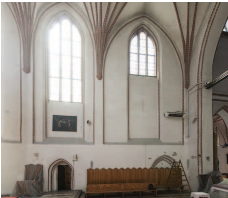
PREZBITERIUM ŚCIANA POŁUDNIOWA zdjęcie stanu zachowania oraz rysunek ze zmapowaną typologią zniszczeń
